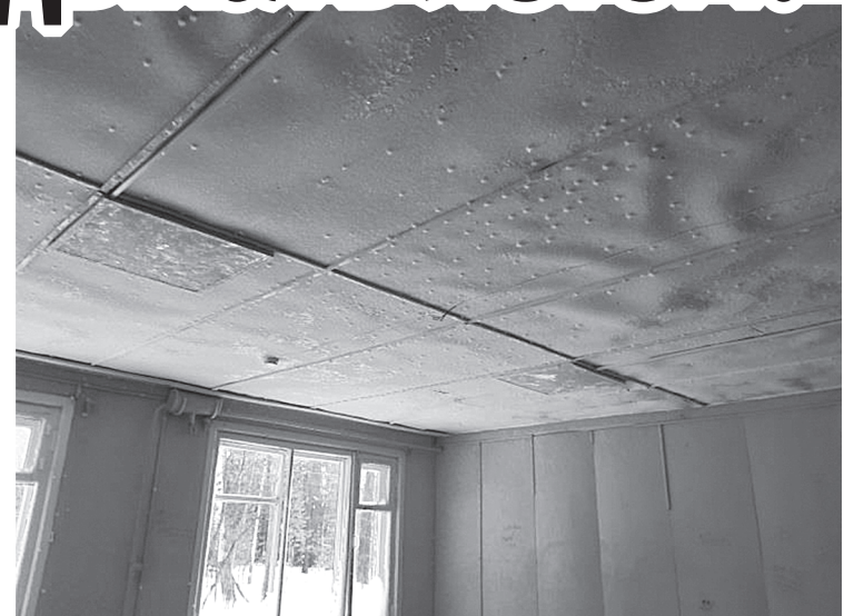
«Солнечный». Прогибы перекрытия. Вздутие потолочной отделки
